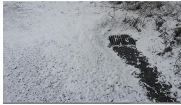
Eksempel på sårbar rist på inntakskum
