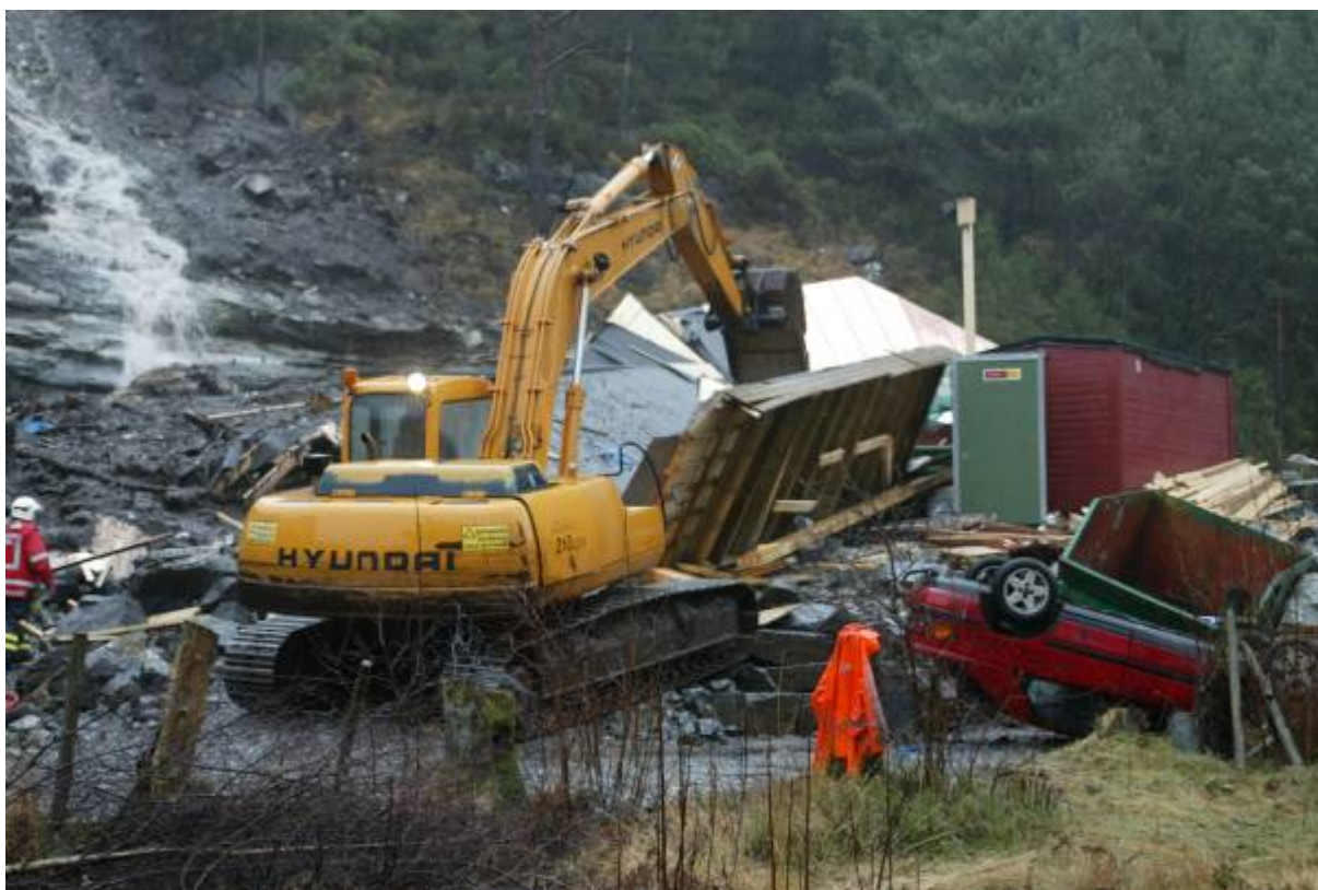
Hetlebakka i Åsane etter ulykka i 2005, der ein mann omkom. (Foto: Bergens Tidende)
