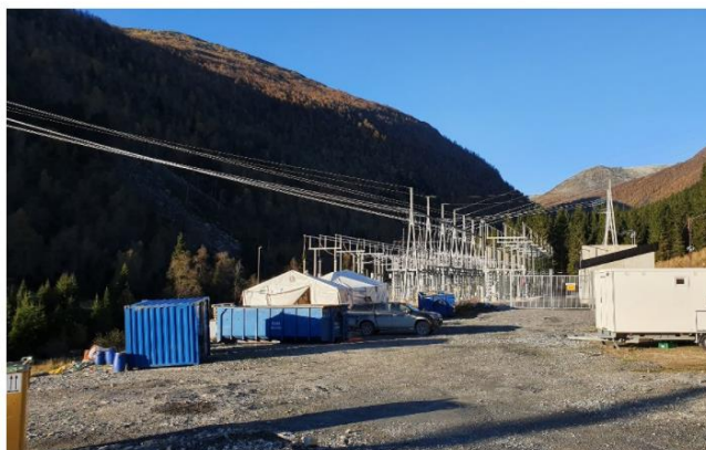
PLANAR: I nærheten av denne trafostasjonen i Leikanger er det planar om eit datasenter. Foto: Anders Huke
