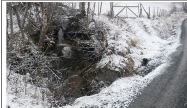
Eksempel på dårlig konstruert bekkeinntak, gjenfylt jordbruksavkjørsel med underdimensjonert drensrør
